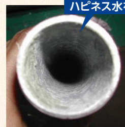
ハピネス水を使用 カルシウムが付着しておらず、配管の素地が見える ※給湯器の設備の延長にもつながります。
